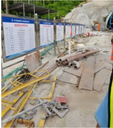
图 25 施工现场文明施工差
