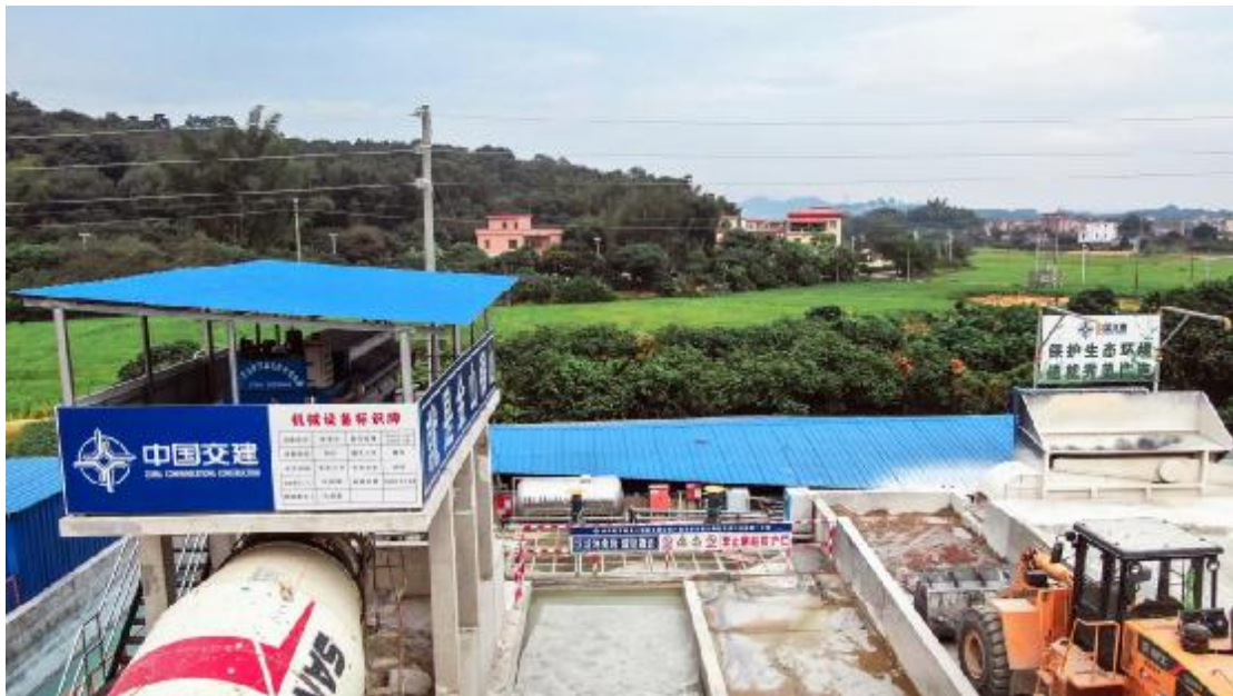
图 9 搅拌站污水处理设备
