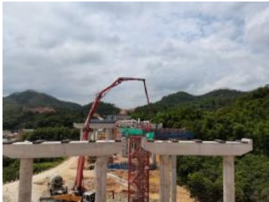
图 26 盖梁垫石施工未设置临边防护措施
