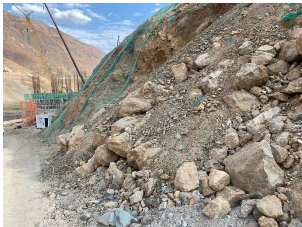
图 33 边坡防护存在缺失
