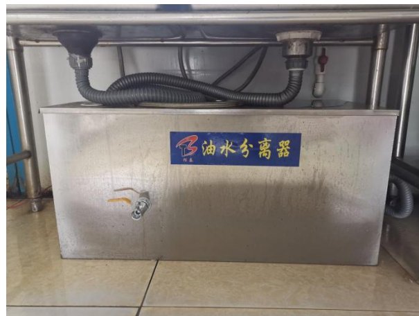
图 29 厨房油水分离器
