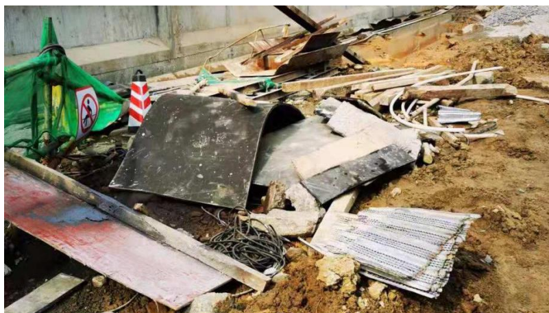
图 30 施工现场物料堆放混乱
