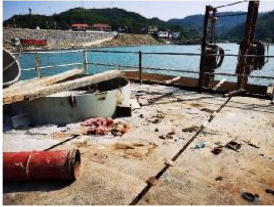
图 20 施工现场文明施工差
