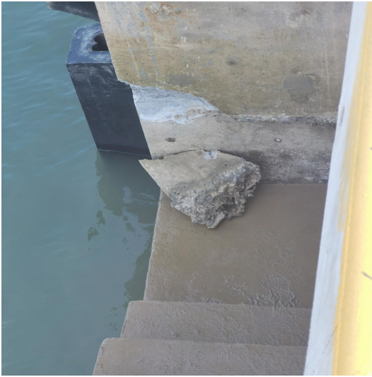
图 31 码头前沿砼崩角
