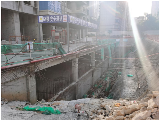
图 33 现场文明施工较差
